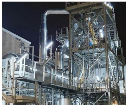
Instalaciones de Salinas de Navarra. Fuente: página web de la empresa
