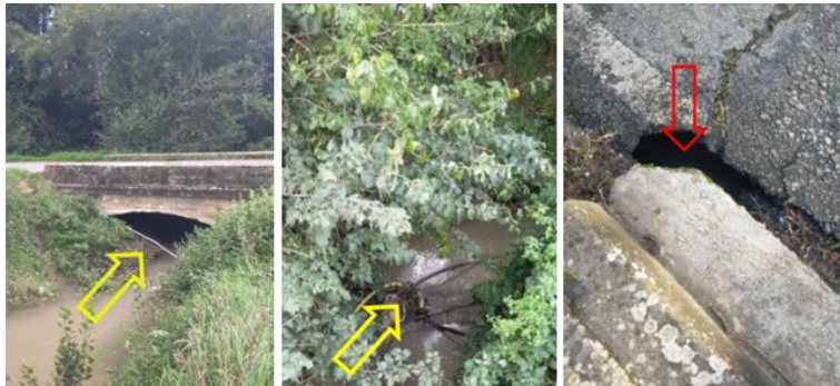
Presencia de mangueras y tubos en el cauce (flechas amarillas) y problemas en la calzada a la altura del puente (flecha roja)
