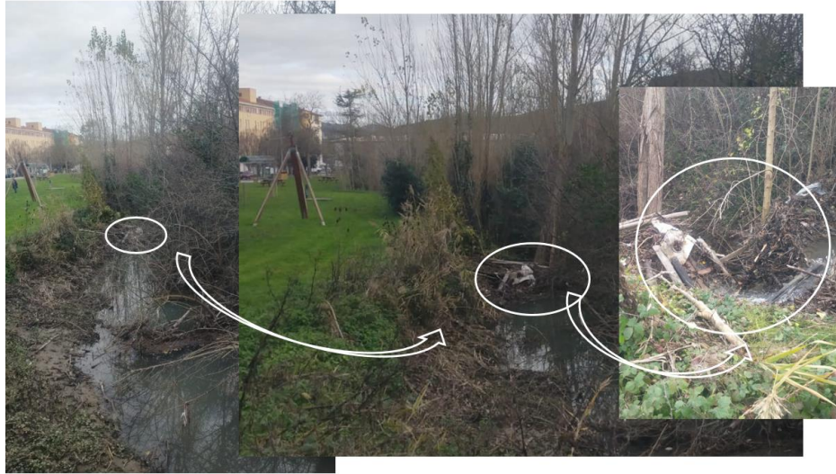
Imagen 36. Aspecto desde el primer puente de las riberas y el cauce donde se observan los taludes desnudos en algún punto y la presencia de tapones en el lecho.
