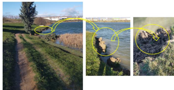
Imagen 54. Rodaduras cerca de zonas críticas, y taludes desnudos que se siguen erosionando por efecto del oleaje y que entre otros efectos dificultan el acceso para los bañistas y enturbian al agua de baño.
