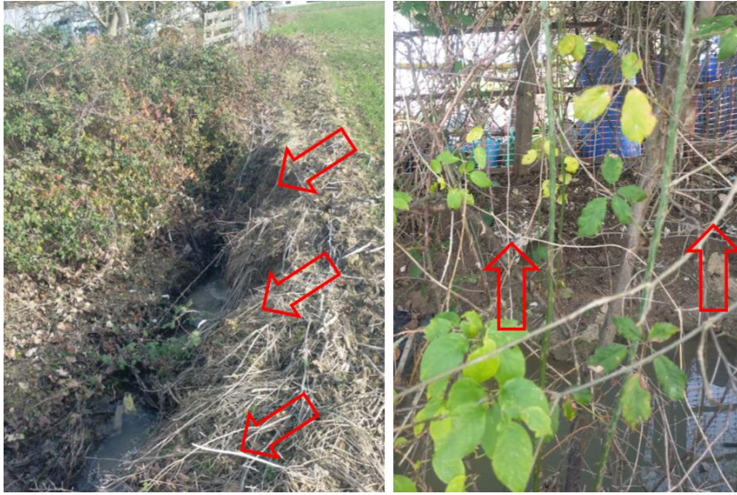
Detalle de dos puntos de erosión por falta de vegetación de ribera y ocupación de la misma por el uso de huerta o campo de cereal.
