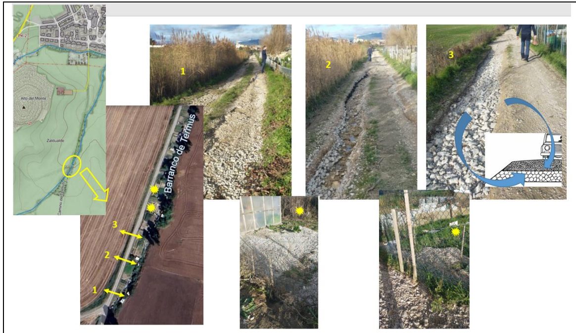
Imagen 27. Detalles de la afección provocada por la salida de las aguas del barranco Termus sobre el camino.
